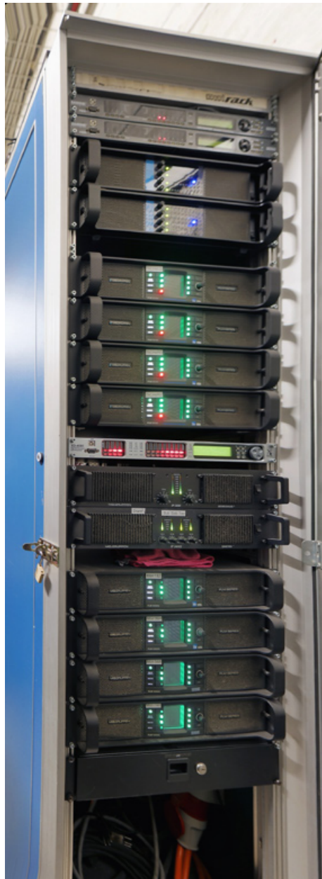
Gestellschrank mit der Audioelektronik für die Tonanlage in der Kulturfabrik Kofmehl. Die obere Vierergruppe im Rack sind die Lab.Gruppen Endstufen für die Stoll Convertible Arrays.
