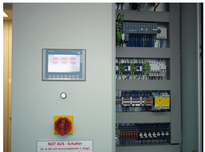
Steuerung der Zu- und Abluftanlage
