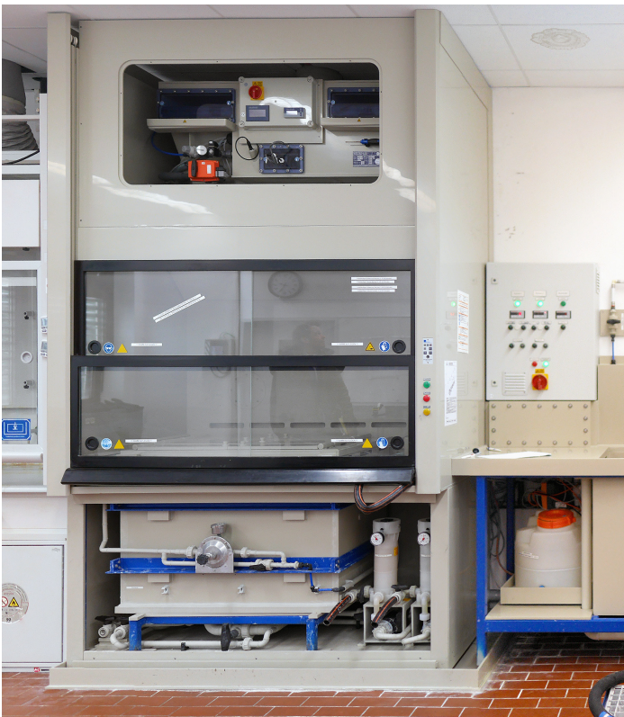
Ätzanlage mit Abzug und Abluftfiltersystem
